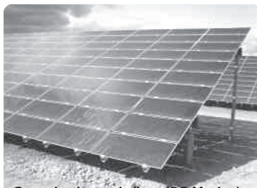
Centrale photovoltaïque (©F. Morlon)
